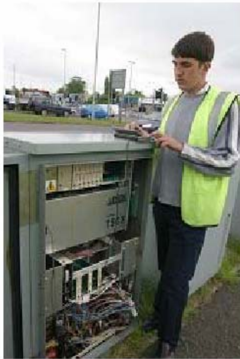
شکل ۴-۳- بازرسی از تابلوی برق سیستم روشنایی
