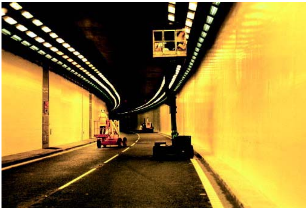
شکل ۴-۵- عملیات نگهداری از روشنایی تونلها
