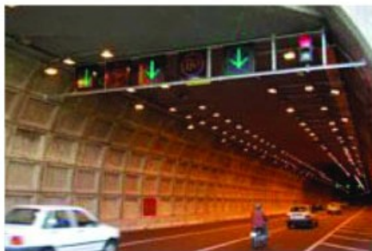
شکل (۲۵). نمونه‌ای از تابلوهای کنترل وضعیت خط و سرعت در تونل رسالت.
